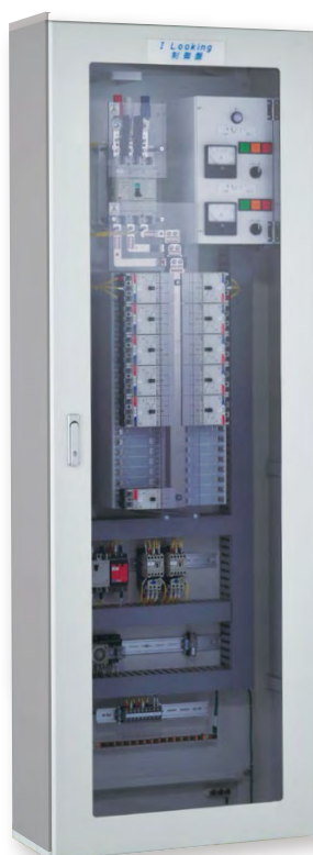
I Looking 制御盤
